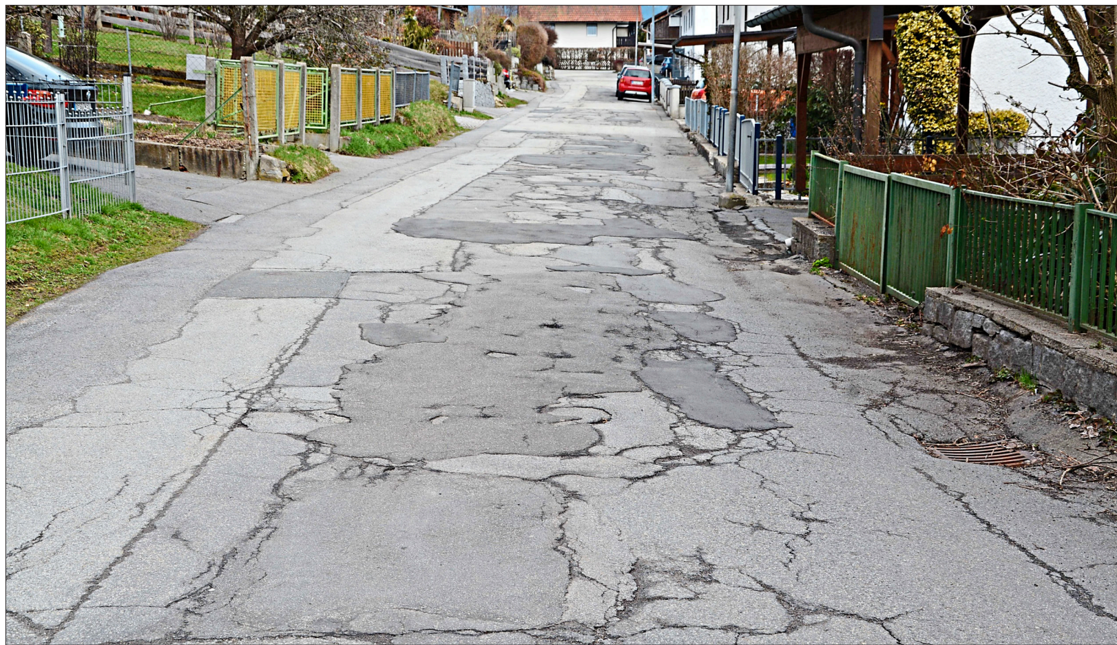
Die völlig ramponierte Rachelstraße ist eine der ganz wenigen Straßen, die dieses Jahr trotz Sparzwangs saniert werden sollen. Allerdings wird nur die oberste Schicht erneuert und nicht, wie ursprünglich geplant, das gesamte Asphaltpaket ausgetauscht. – Foto: Schlenz
